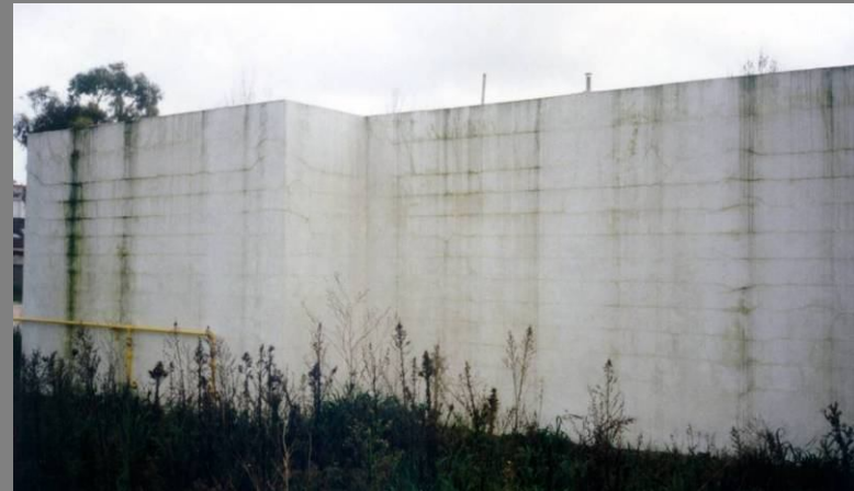
Lisboa, década de 90, rebocos hidráulicos
